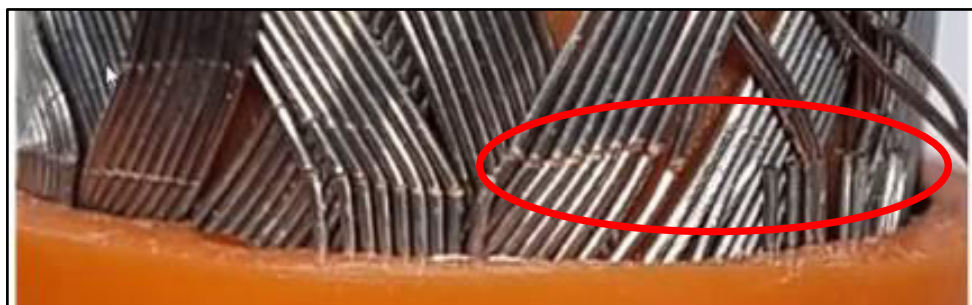
Fig. 3.2.3 a: Error pattern damaged strands 3.2.3 (to 3.2.3.Step 1) Bild 3.2.3 a: Fehlerbild beschädigte Litzen zu Bild 3.2.3 Stufe 1
